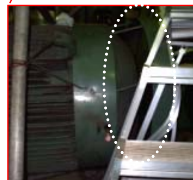
上部カバーの変形
