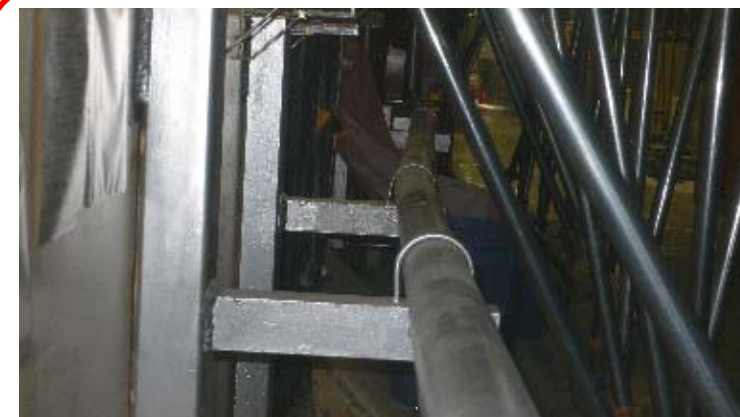
変形したトレンチ内の配管
