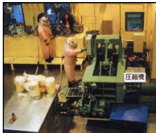
廃棄物の圧縮処理
